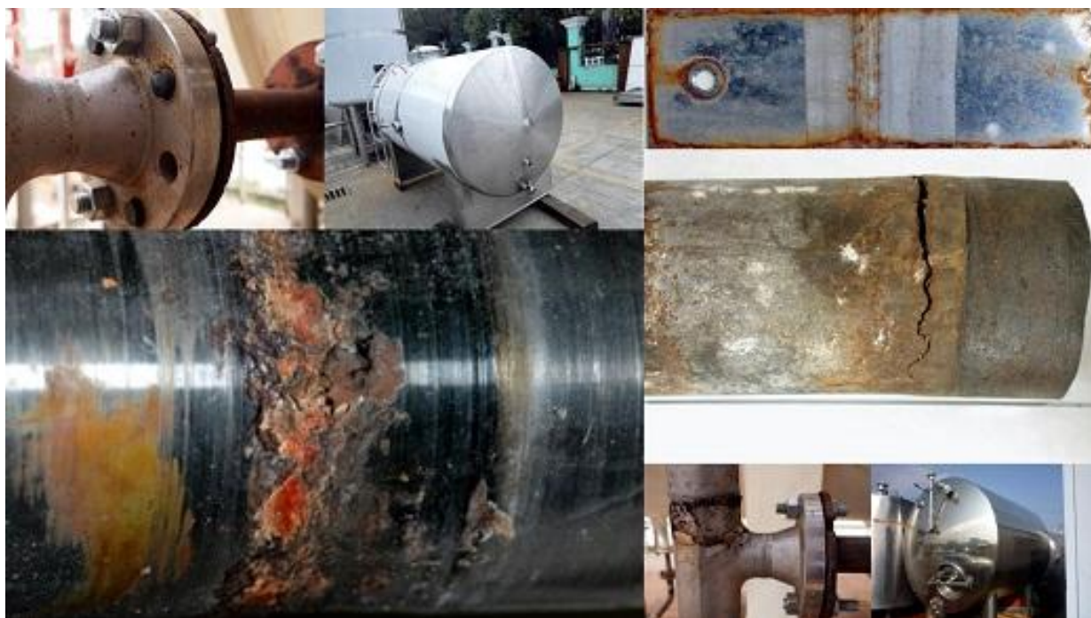
Рисунок 4 - Коррозия изделий в процессе эксплуатации
