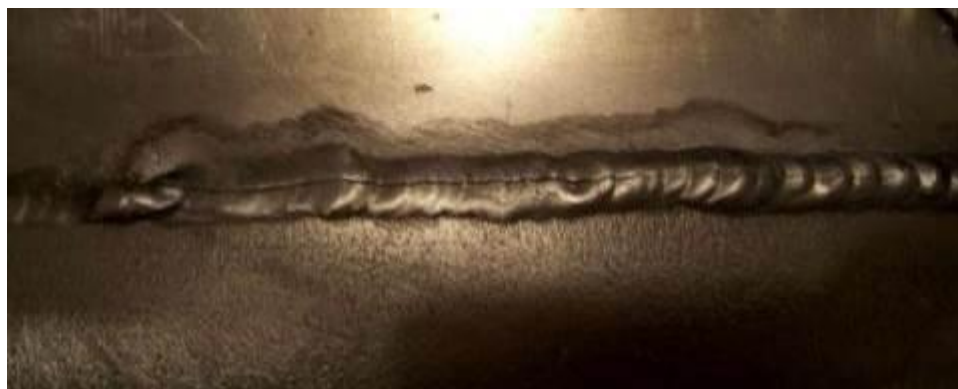
Рисунок 10 – Трещина в сварном шве
