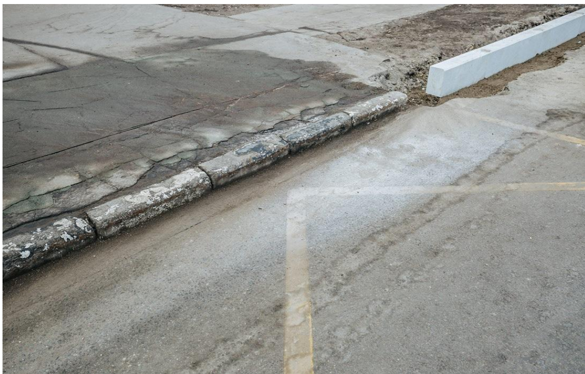
Рисунок 1.3 – Монтажный дефект уровня
