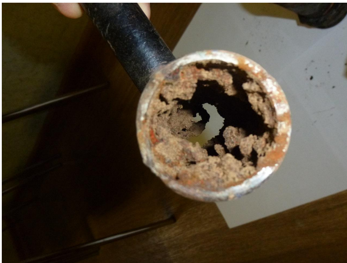
Рисунок 2.16 – Отложения в трубопроводах системы ГВС
