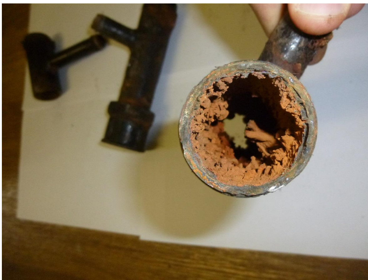
Рисунок 2.13 – Отложения в трубопроводах системы ГВС
