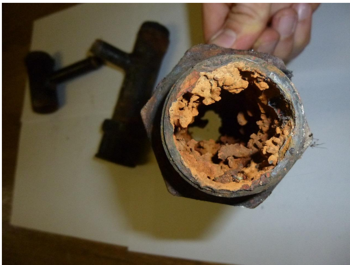
Рисунок 2.14 – Отложения в трубопроводах системы ГВС
