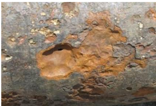
Рисунок 1.3 – Пример локальной коррозии
