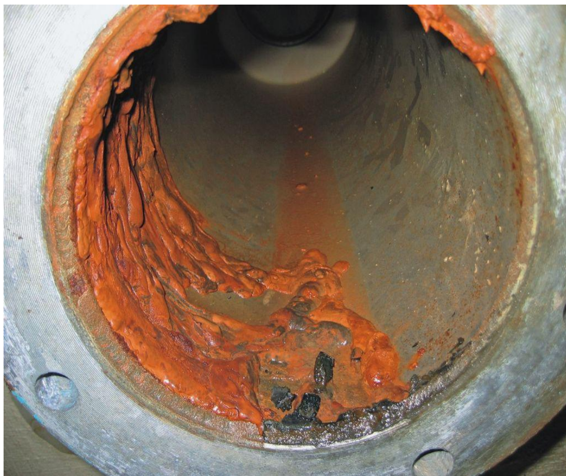
Рисунок 5 - Внутренняя коррозия стенок трубопровода
