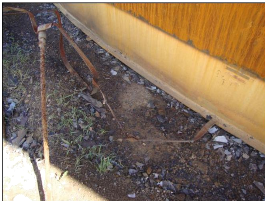
Рисунок 7 - Элемент заземления, расположенный с западной стороны резервуара
