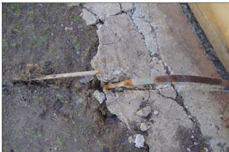
Рисунок 5 - Элемент заземления, расположенный с северной стороны резервуара
