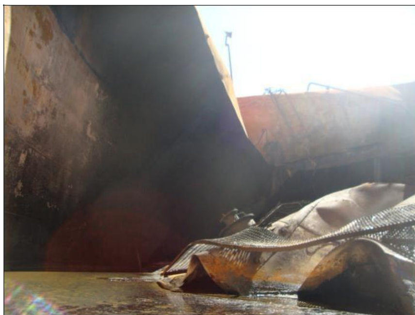
Рисунок 8 - Участок внутренней поверхности северо-восточной стенки резервуара. Элементы конструкции кровли резервуара на дне резервуара.
