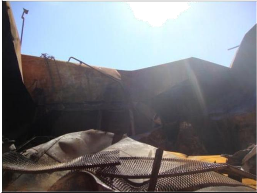
Рисунок 9 - Участок внутренней поверхности южной стенки резервуара. Элементы конструкции кровли на дне резервуара.
