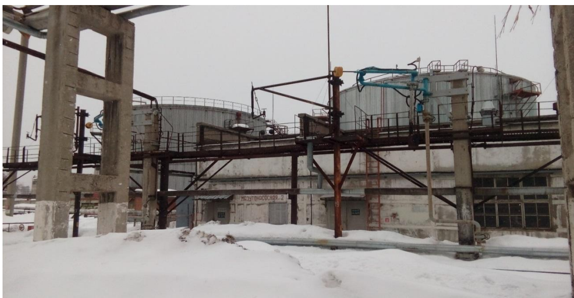
Рисунок 9 - Устройство верхнего налива на сливной эстакаде М/Н №2
