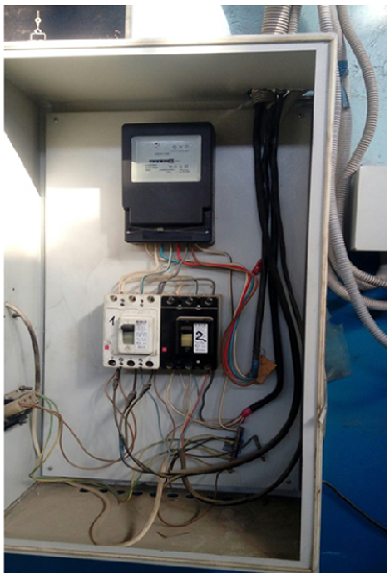
Рисунок 4.1 – Щит управления питанием кран-балкой и освещением
