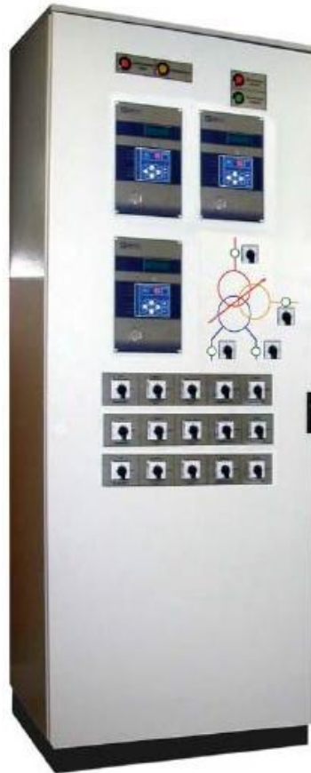
Рисунок 20 – Шкаф комплекта защиты трансформатора
