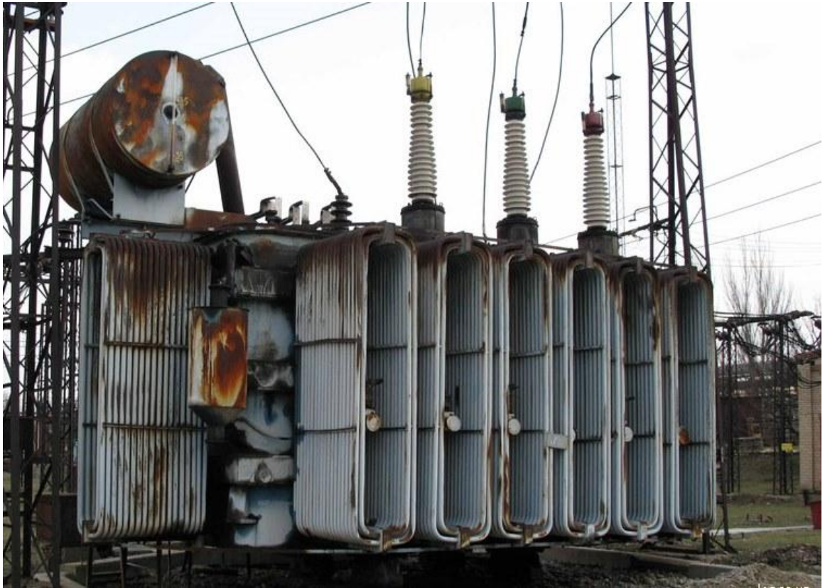
Рисунок 4 – Силовой трансформатор Т-2
