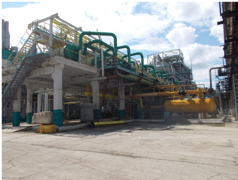
Рисунок 1.2 – «Общий вид установки компримирования» [31].
