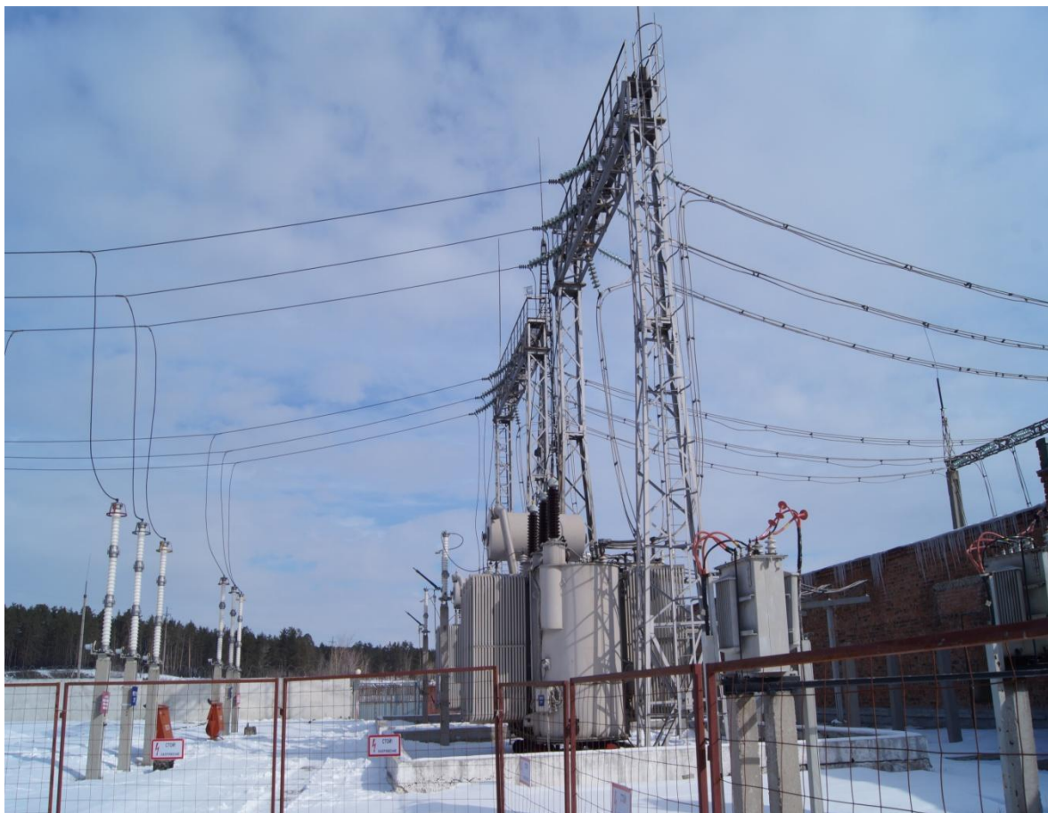
Рисунок 1 – Фото некоторой части подстанции
