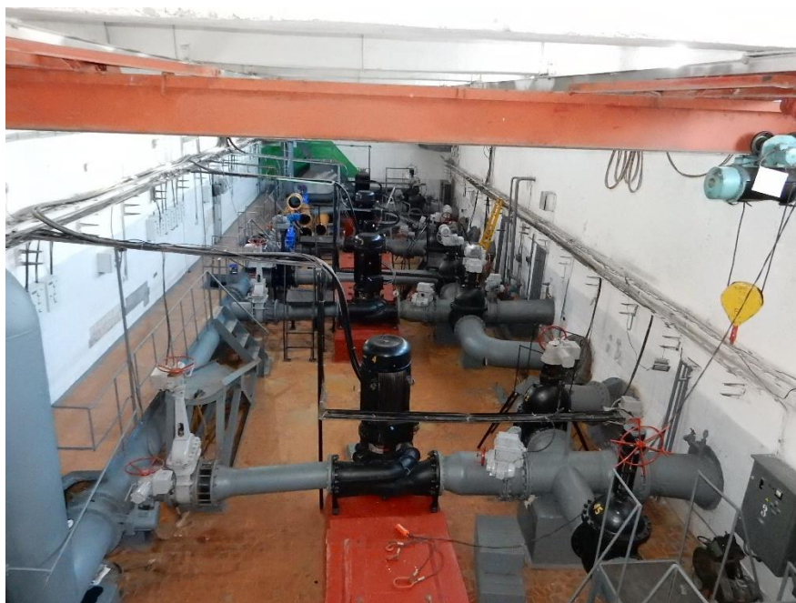
Рисунок 2.6 – Общий вид машинного зала
