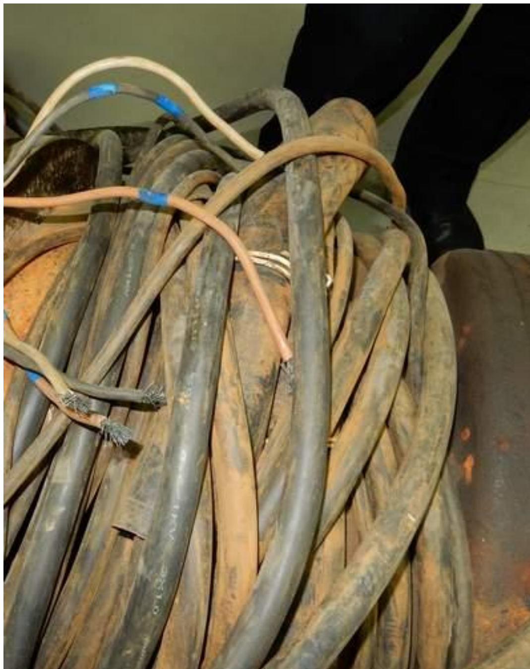
Рисунок 2.23 – Силовые и контрольный кабели
