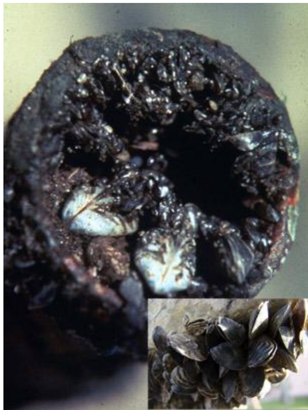
Рисунок 1.2 – Блокирование насоса и трубопровода дрейссеной
