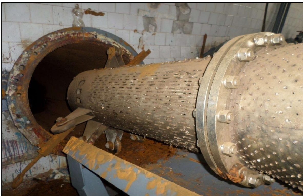
Рисунок 2.11 – Вышедший из строя глубинный, погружной насос водоприёмного оголовка №3 (насос полностью забит створками моллюска Речная дрейссена и донными отложениями)
