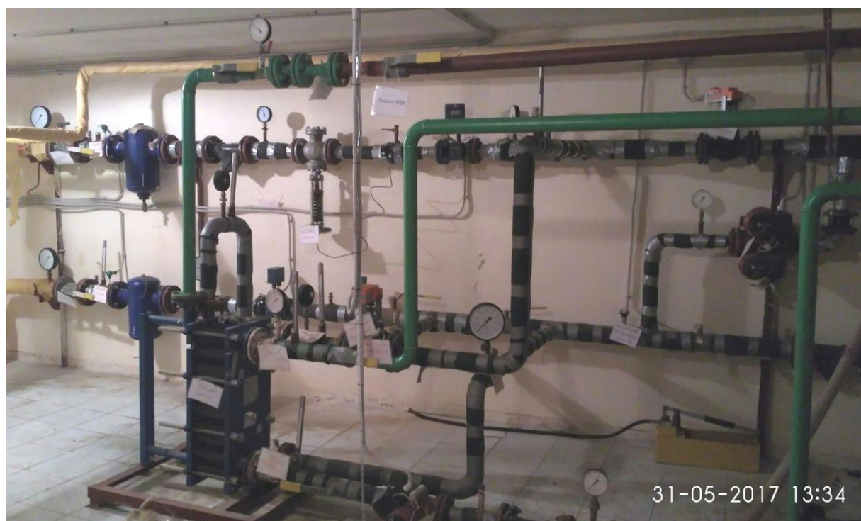
Рисунок 2.10 – Тепловой узел Объекта 2
