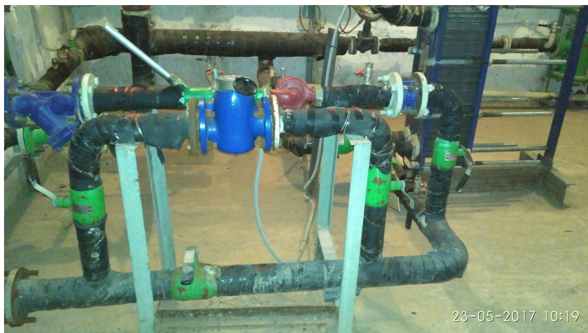
Рисунок 2.24 – Фрагмент теплового узла Объекта 4, где согласно принципиальной схеме должен быть установлен прибор ГМС
