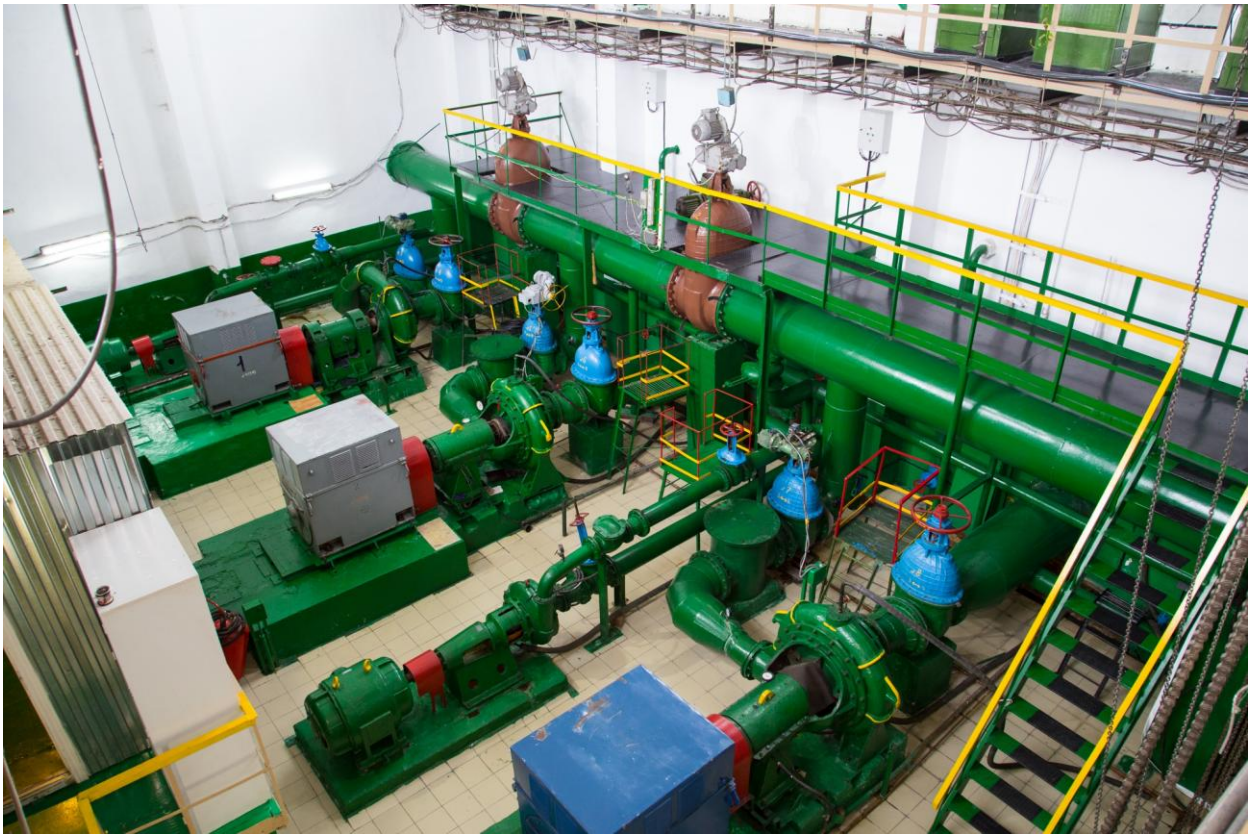
Рисунок 1.2 – Станция подъема ООО «Волжские коммунальные системы»
