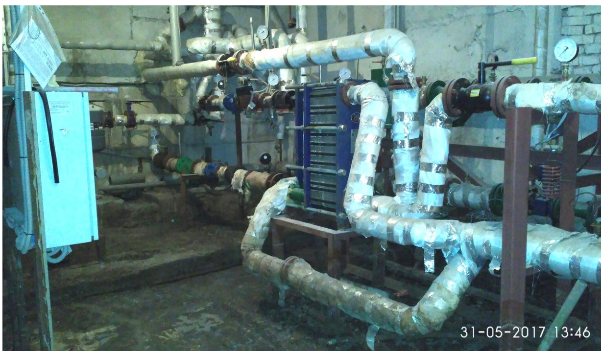
Рисунок 2.3 – Тепловой узел Объекта 1
