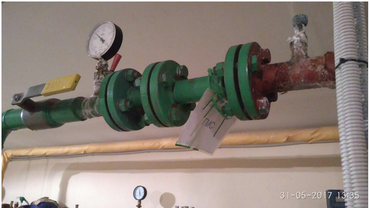
Рисунок 2.12 – Прибор ГМС-32 (гидромагнитная система) Объекта 2
