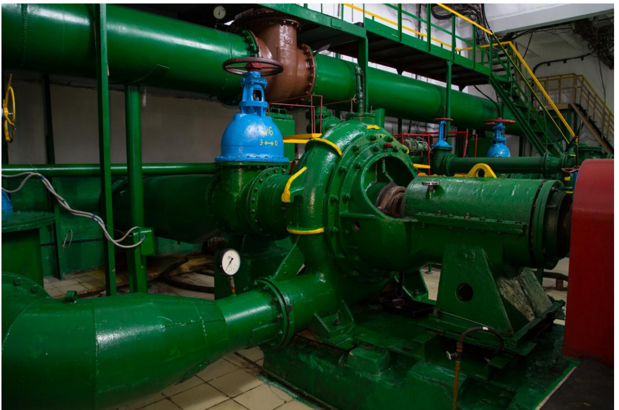
Рисунок 1.3 – Станция подъема ООО «Волжские коммунальные системы»
