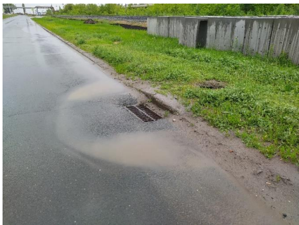
Рисунок Б.5 – Смыв грунта на дороге
