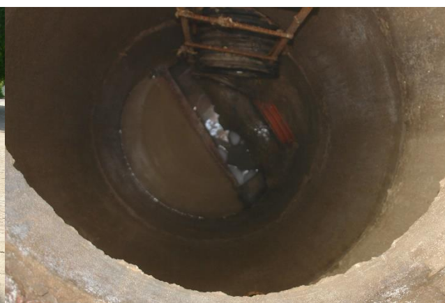
Рисунок 35 – Состояние лотков удовлетворительное, засорения нет
