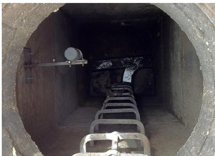
Рисунок 40 – Стационарная установка расходомера в колодце
