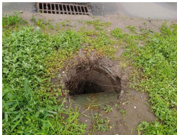
Рисунок Б.6 – Повреждённая крышка колодца
