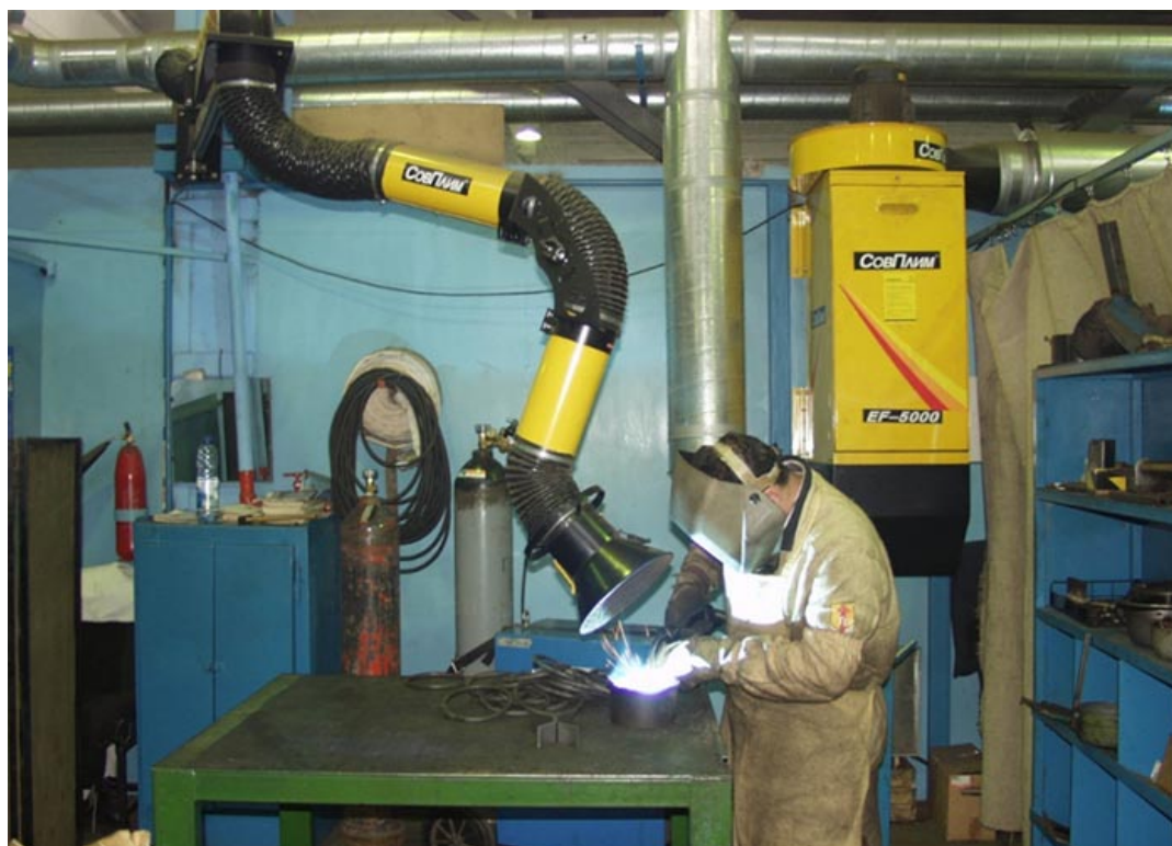
Рисунок 7 – Сварочный пост с оборудованной местной вытяжной вентиляцией
