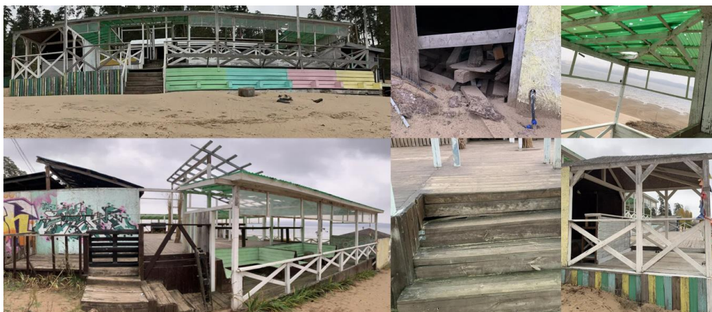
Рисунок 8 – Состояние кафе на территории Итальянского пляжа
