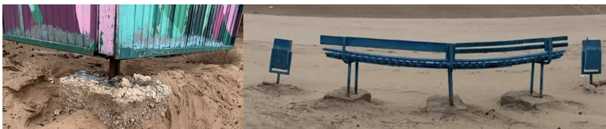
Рисунок 11 – Состояние фундамента на объектах благоустройства
