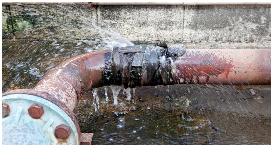
Рисунок 9 – Утечка из водопроводных труб
