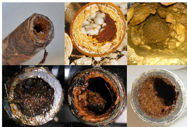
Рисунок 10 – Отложения в водопроводных трубах
