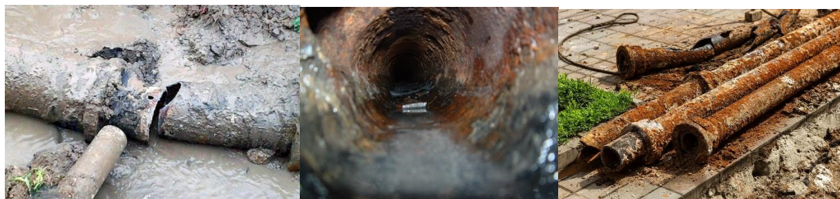
Рисунок 12 – Повреждения канализационных трубопроводов
