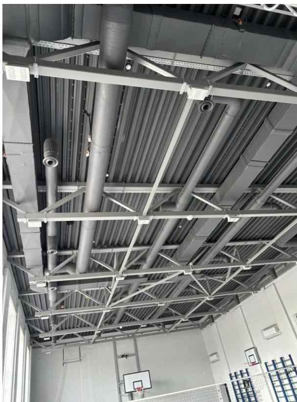
Рисунок 1 – Система вентиляции в спортивном зале
