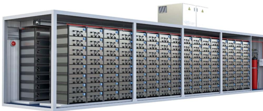
Рисунок 1 – Система хранения энергии с системой противопожарной защиты
