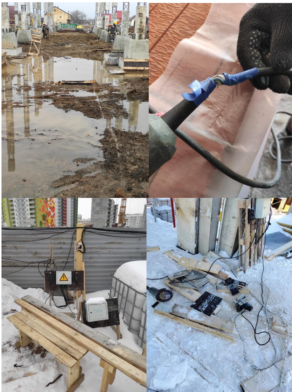
Рисунок 2 - Фотоотчет по выявленным на объекте нарушения
