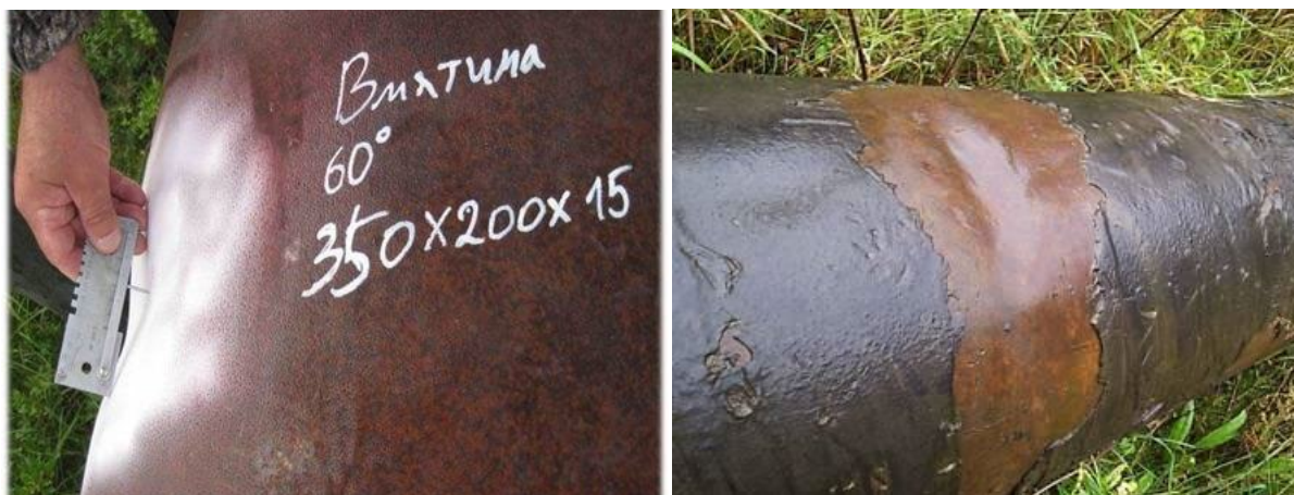
Рисунок 2 – Вмятины на магистральном трубопроводе
