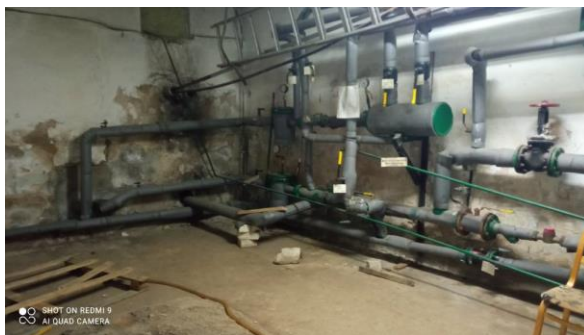
Рисунок 11 – Индивидуальный тепловой пункт в подвале корпуса «Д»
