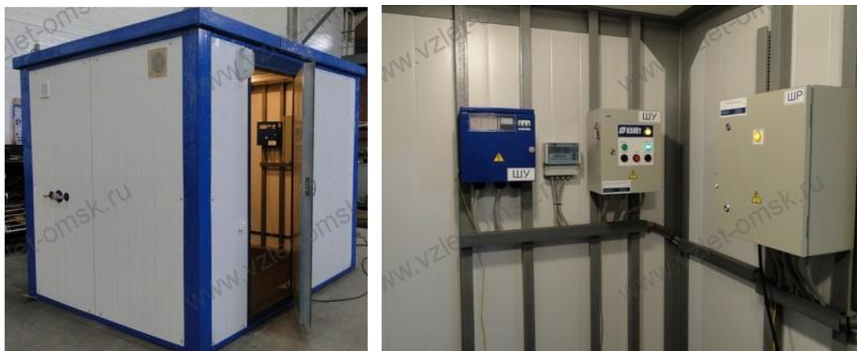
Рисунок 17 – Павильоны, используемые как блочные насосные станции над артезианскими скважинами
