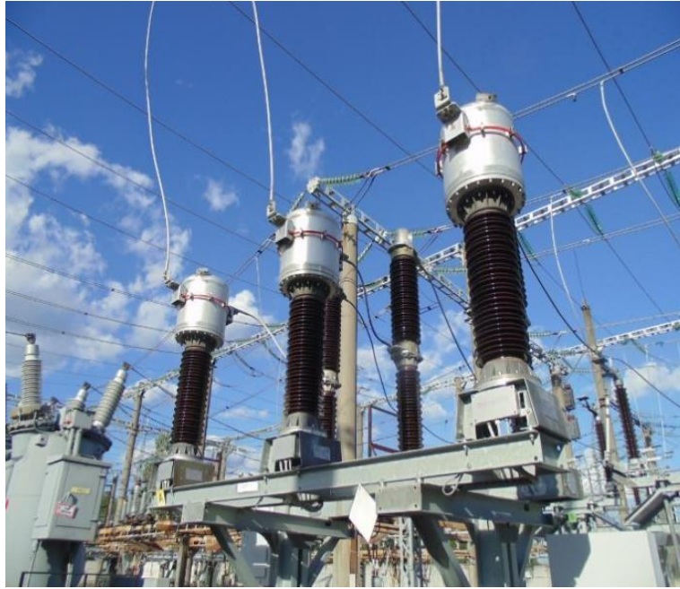
Рисунок 5 – Трансформаторы тока ТОГФ-110
