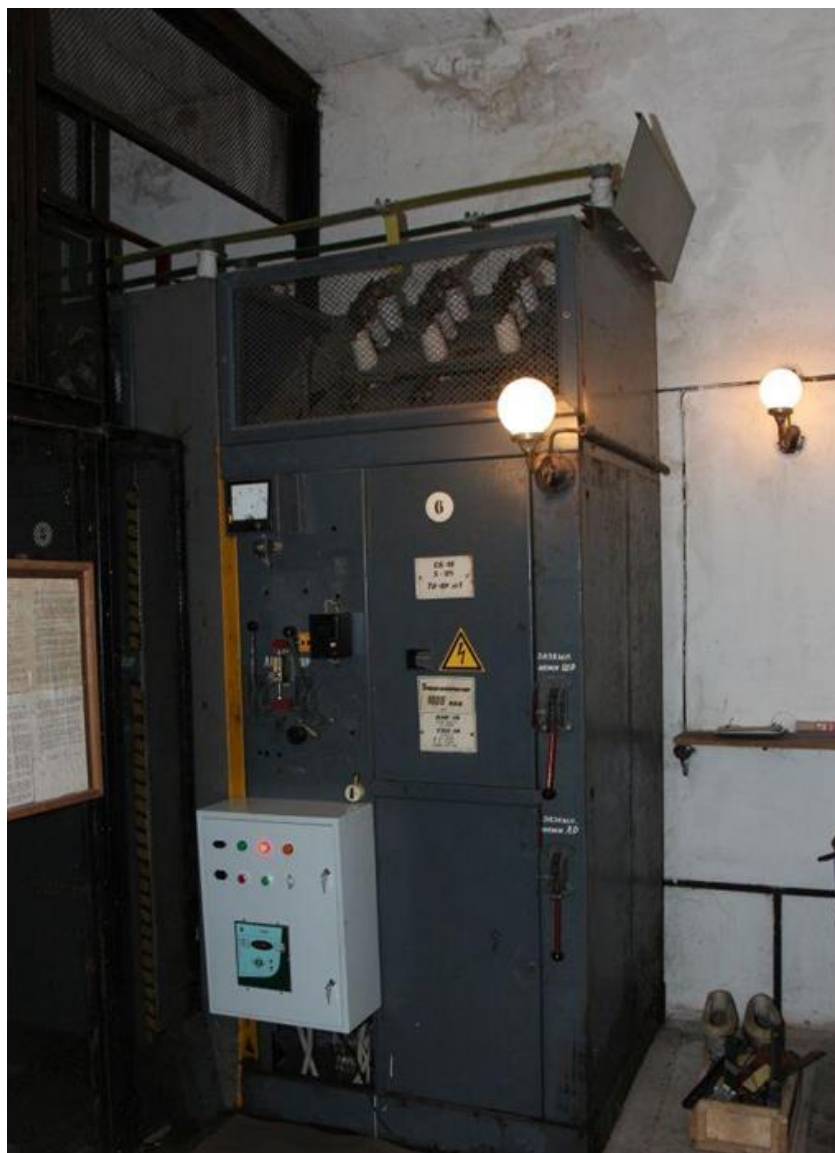
Рисунок 1 - Внешний вид ячейки КСО, установленной на стороне 10 кВ КТП-22
