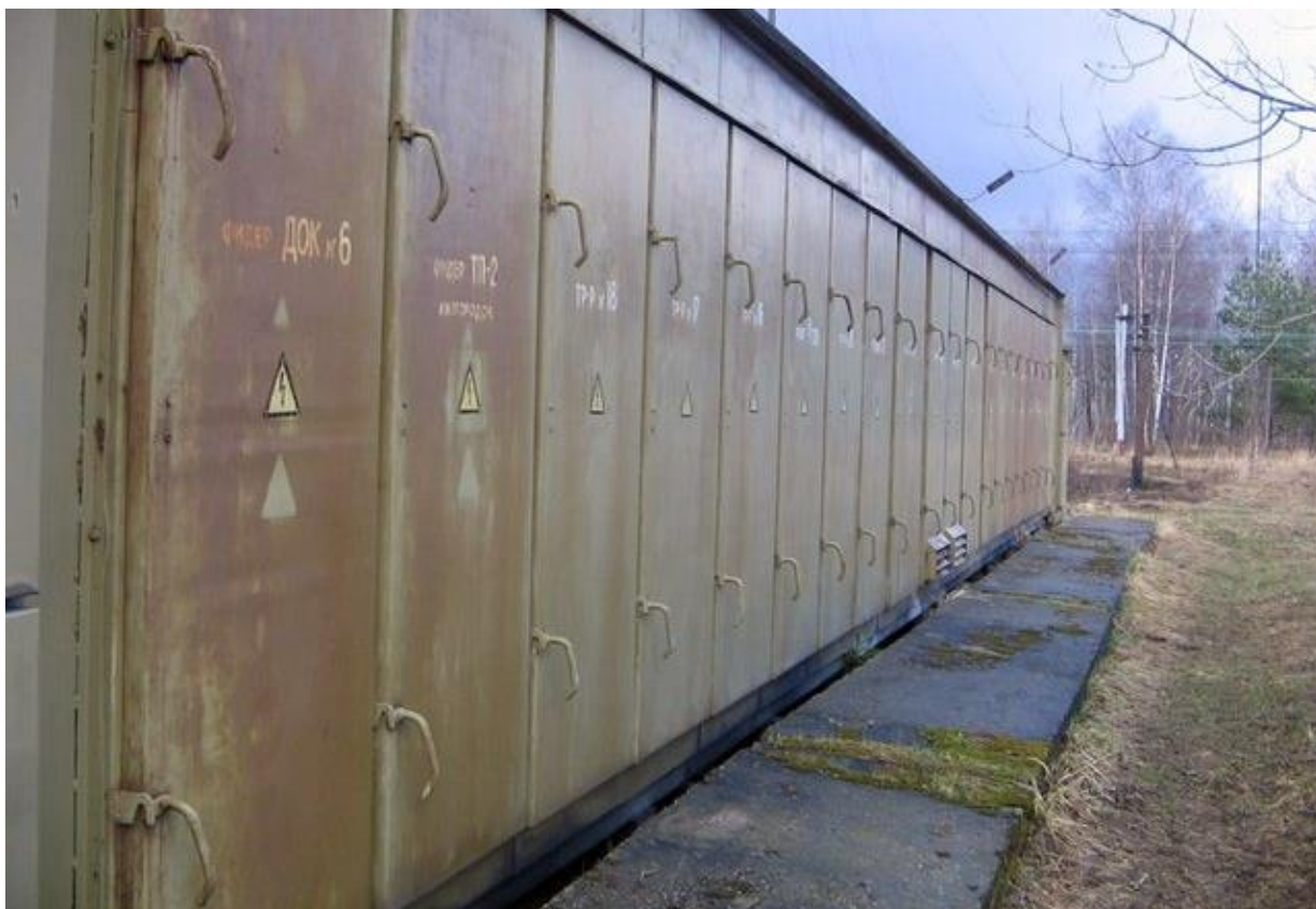
Рисунок 2 – КРУ-10 ПС 110/10 кВ Юрьевская
