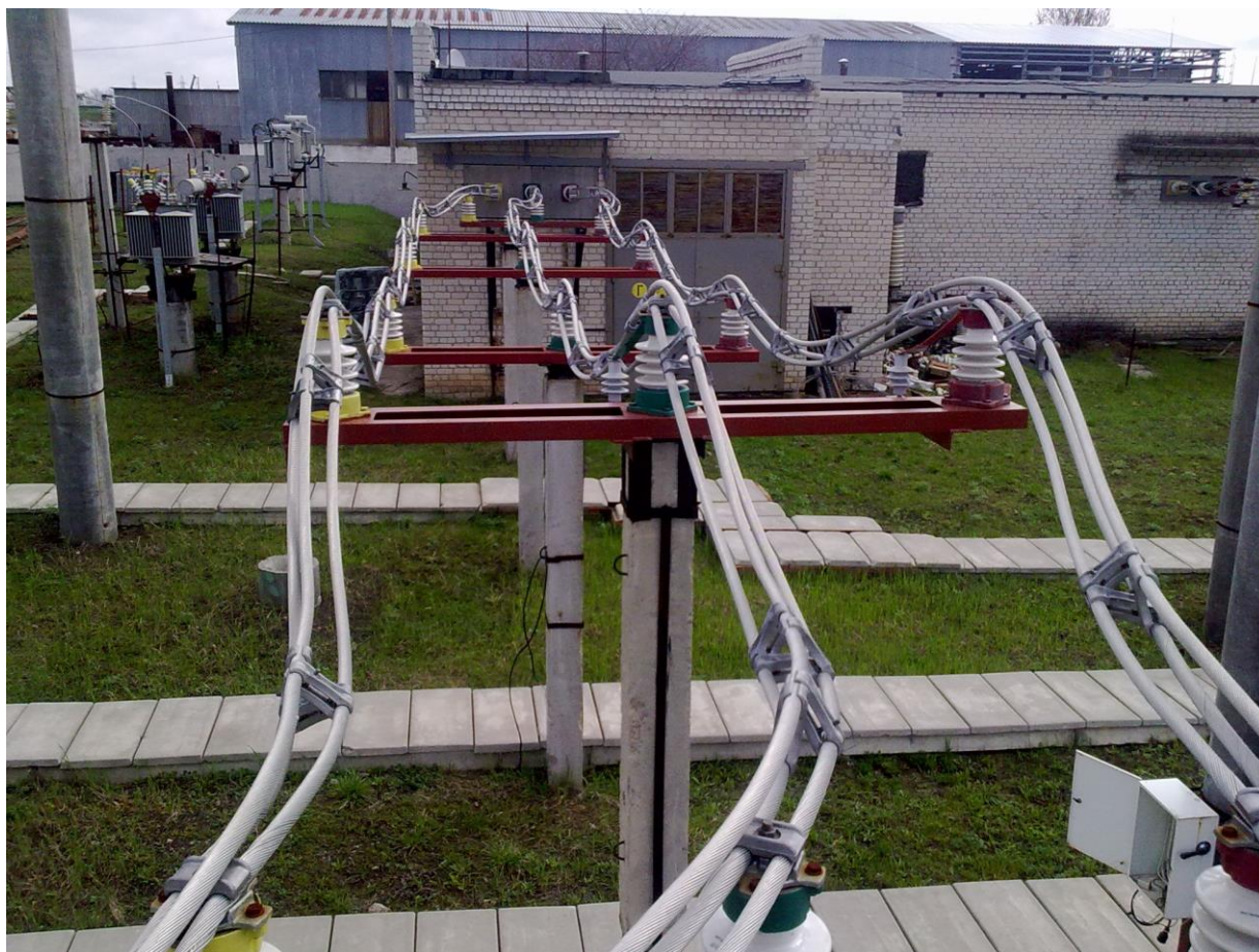
Рисунок 6 – Внешний вид шинного моста на стороне НН подстанции.
