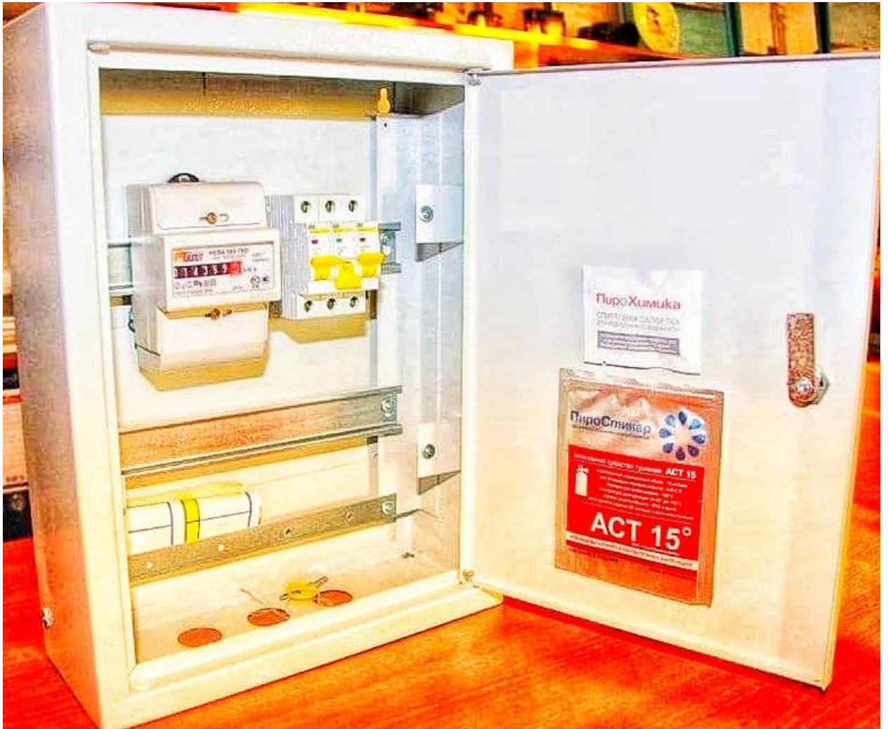
Рисунок 6 – Пиростикер закрепленный в корпусе с электрооборудованием
