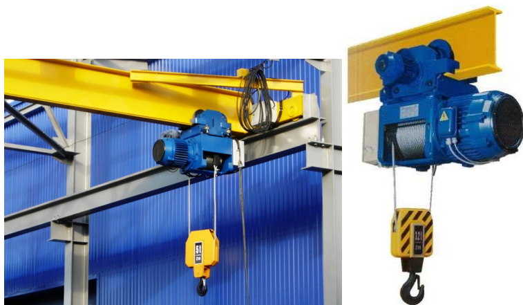
Рис. 3.49. Кран-балка с электрической талью
