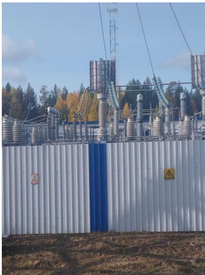
Рисунок 2 – Фото части подстанции 110/10 кВ «Агириш»
