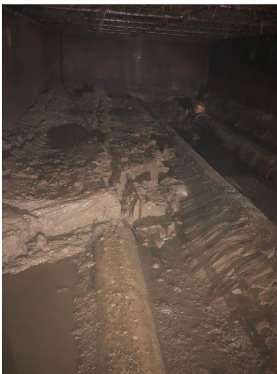
Рисунок 6 – Камера осаждения горизонтального отстойника со шламом
