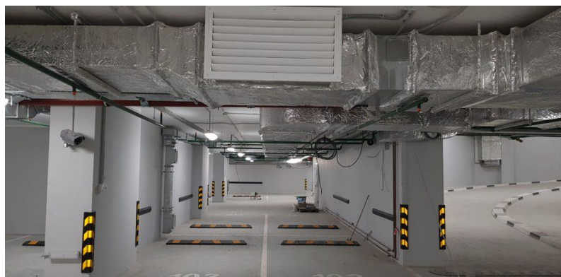
Рисунок 8 – Пример крытой автостоянки с системой воздуховодов
