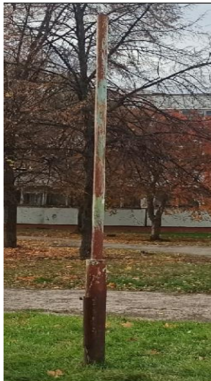
Рисунок 11 – Опора без светильника
