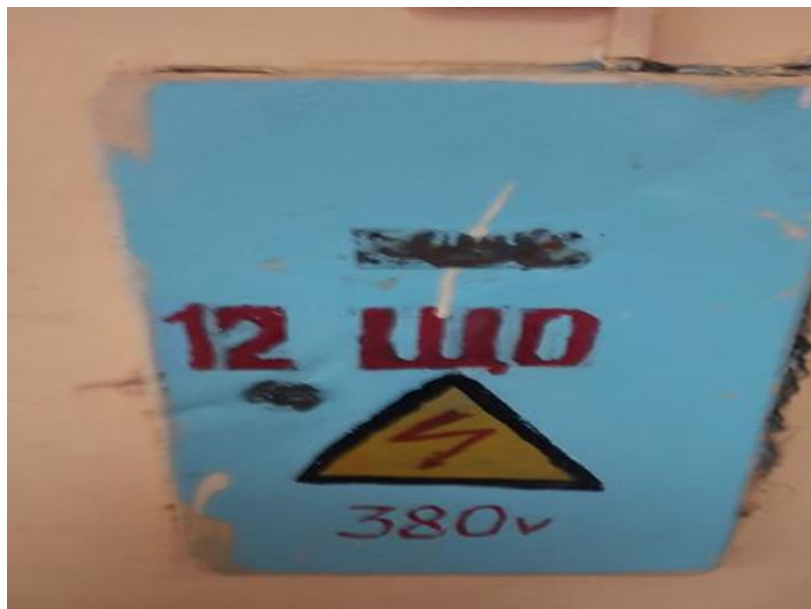
Рисунок 4 – Состояние щита освещения №12
