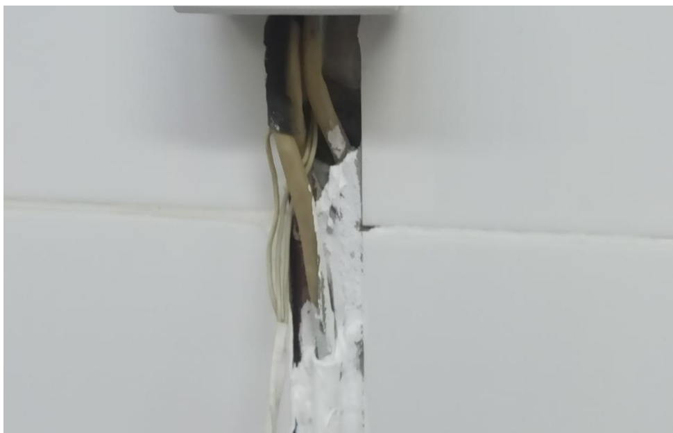
Рисунок 8 – Провода открыто торчат из стены
