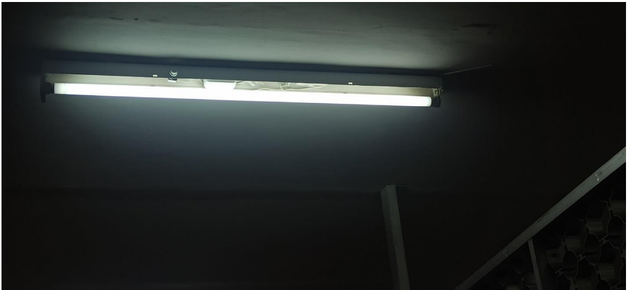
Рисунок 10 – Отсутствие рассеивателя на люминесцентном светильнике
