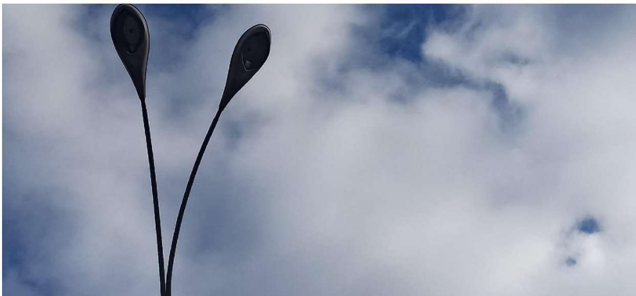
Рисунок 12 – Отсутствие лампы в светильниках
