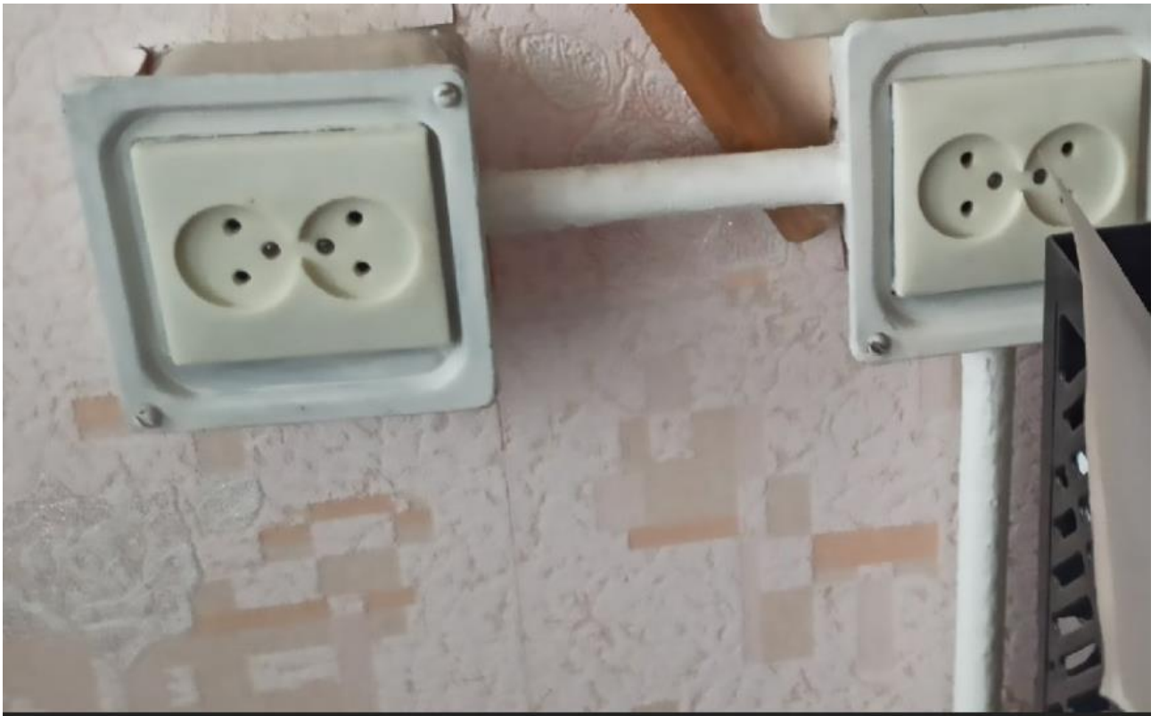
Рисунок 5 – Устаревшие розетки без защитных «шторок»
