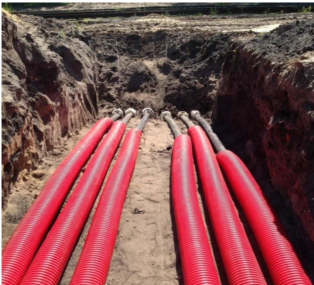
Рисунок 7 – Кабельная линия электропередач
