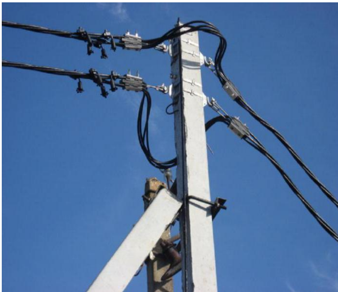
Рисунок 9 – Провода СИП на опоре ВЛ 0,4 кВ
