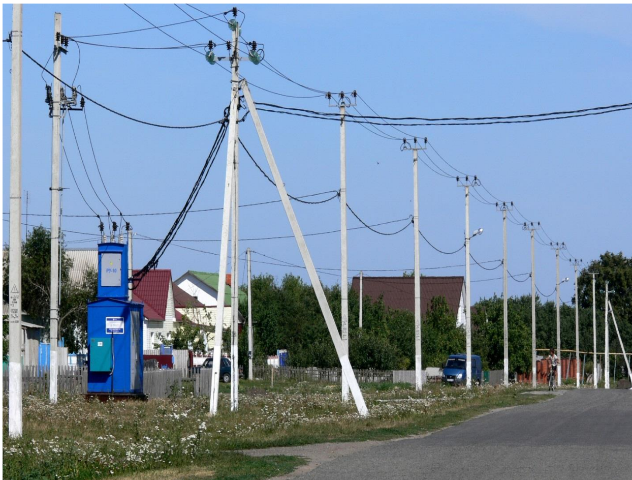
Рисунок 8 – Воздушная линия электропередач
