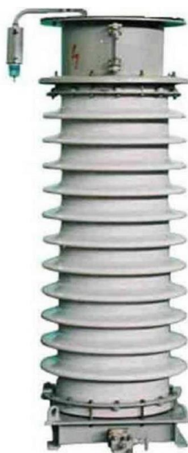
Рисунок 14 – Внешний вид трансформатора НКФ-110-58У1
