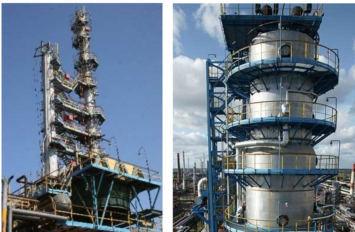
Рисунок 1 – Внешний вид установки каталитического риформинга
