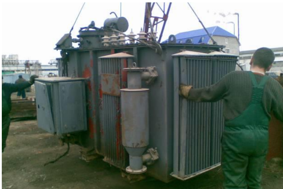
Рисунок 4 – Трансформатор марки ТНЗП
