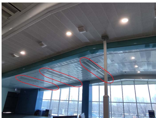
Рис. 2. Пример применения потолочных балок в офисном помещении со свободной планировкой. Красным цветом выделены потолочные балки, смонтированные в подвесном потолке
