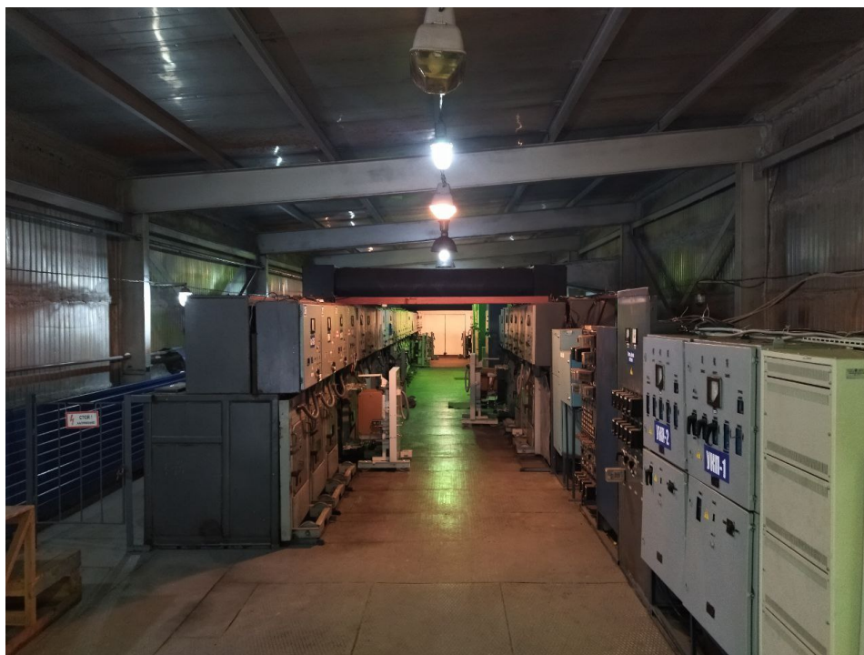
Рисунок 2 – Внутренний вид ЗРУ-6кВ «Янтарная»
