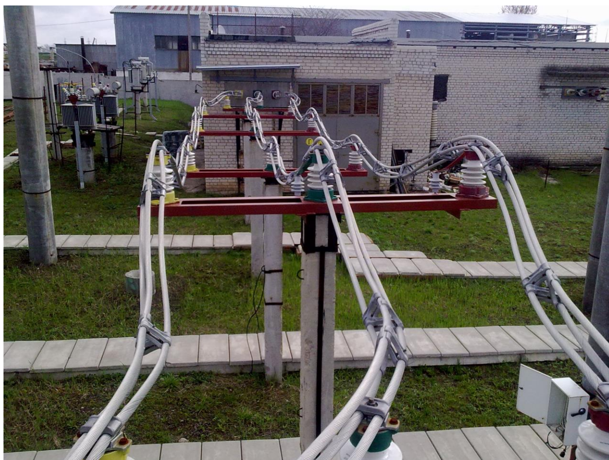
Рисунок 7 – Шинный мост на стороне НН подстанции
