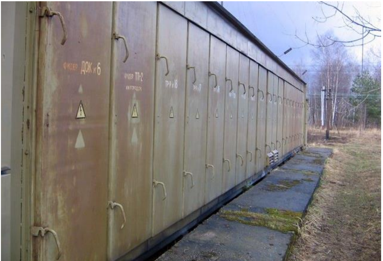
Рисунок 2 – КРУ-10 ПС 110/10 кВ Ялуторовск
