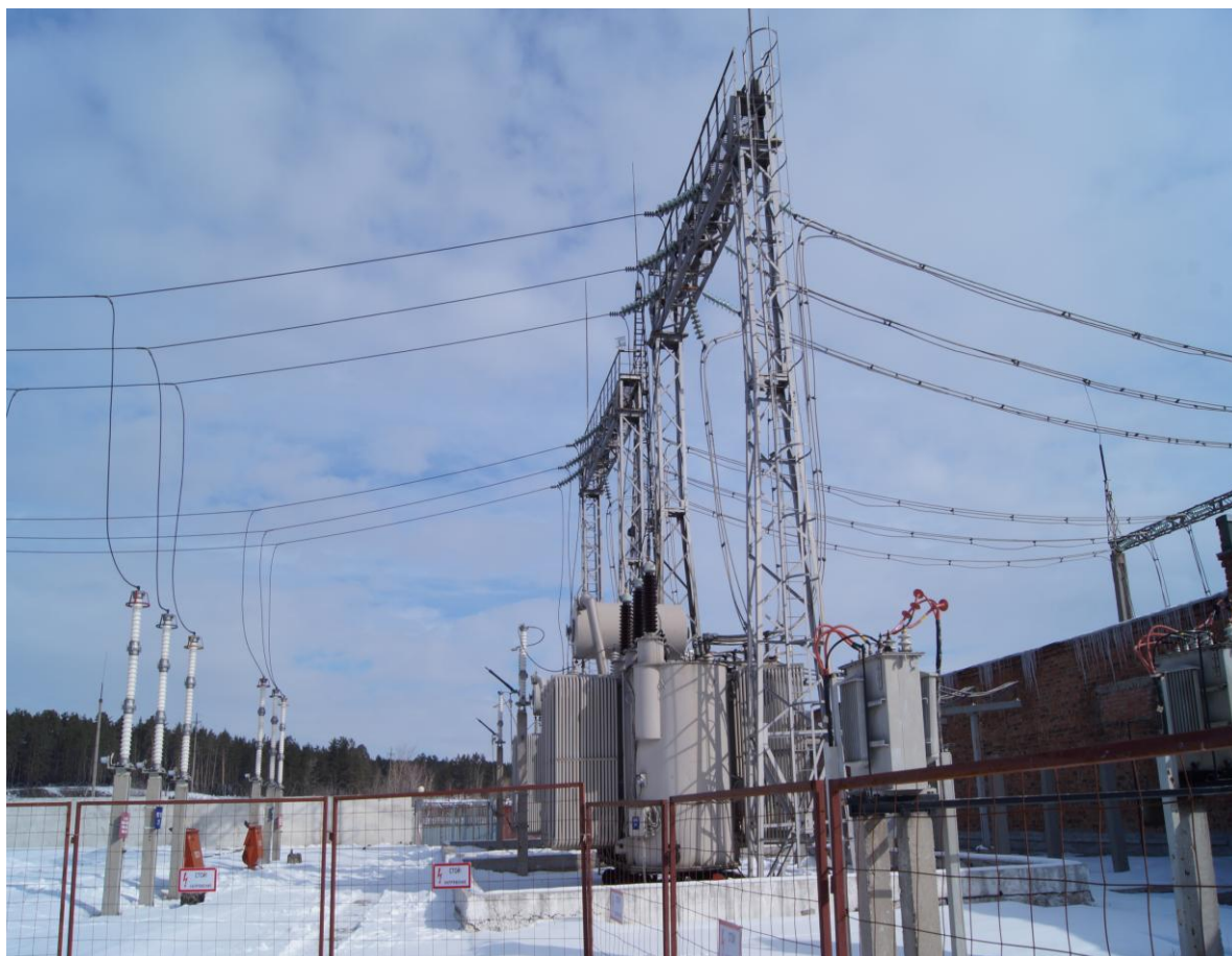
Рисунок 2- Фото некоторой части подстанции
