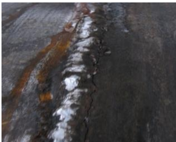
Рисунок 4 – Трещина в месте ремонтной сварки
