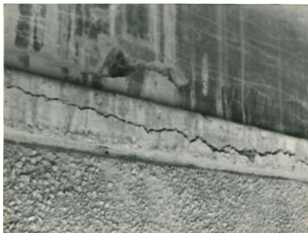
Рис. 5. Разрушенный монолитный бетон жилого дома
