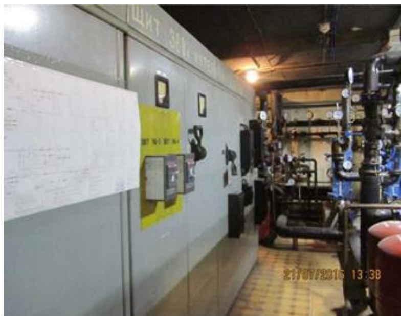
Рисунок 1 – Существующее РУ-0,4кВ 16ТС
