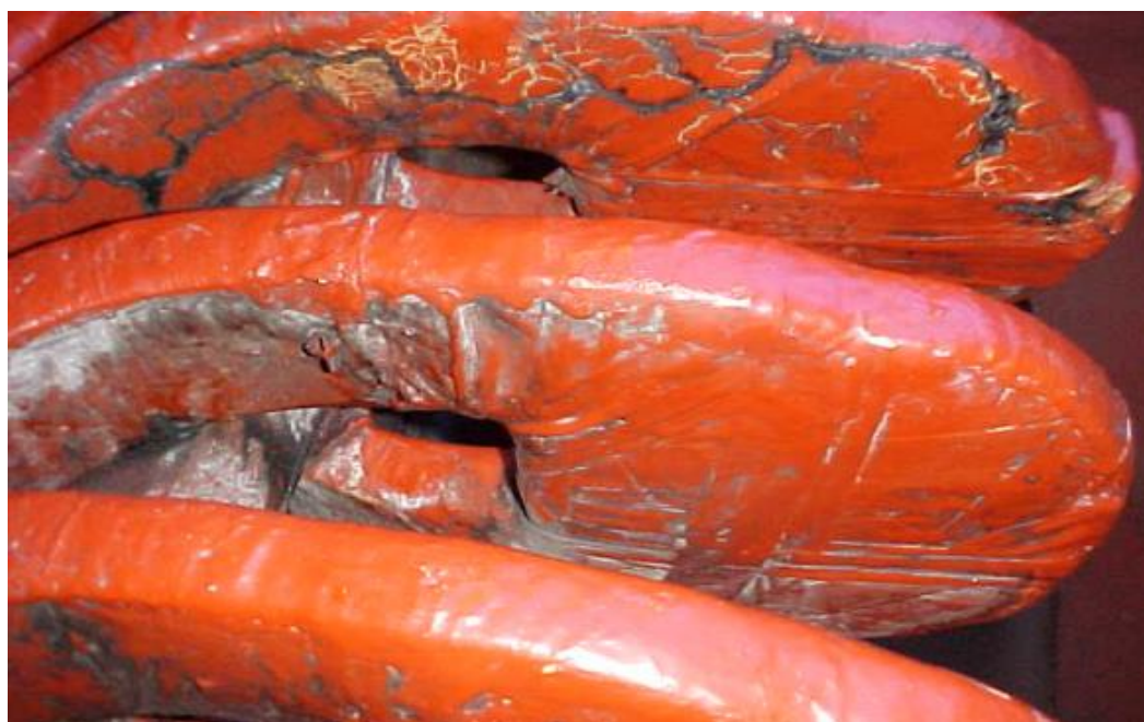
Рисунок 5 – Частичный разряд в изоляции
