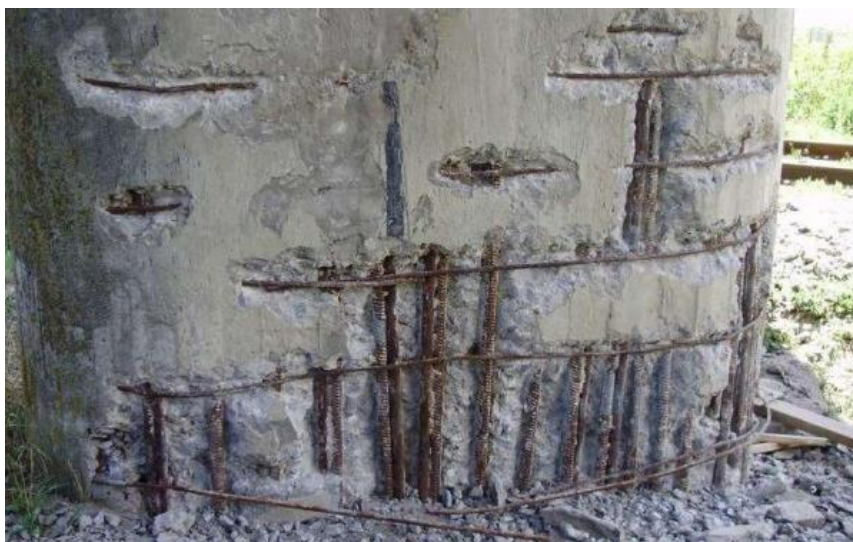
Рисунок 7 – Кислотная коррозия бетона
