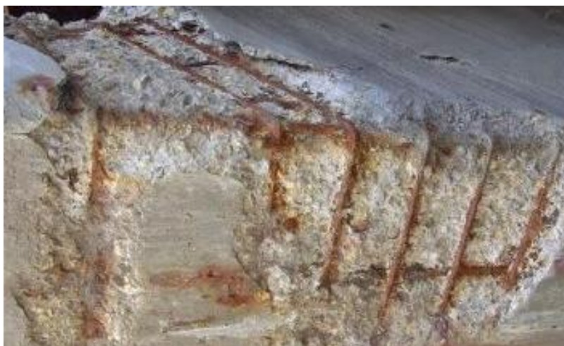
Рисунок 9 – Конструкция, подверженная сульфатной коррозии
