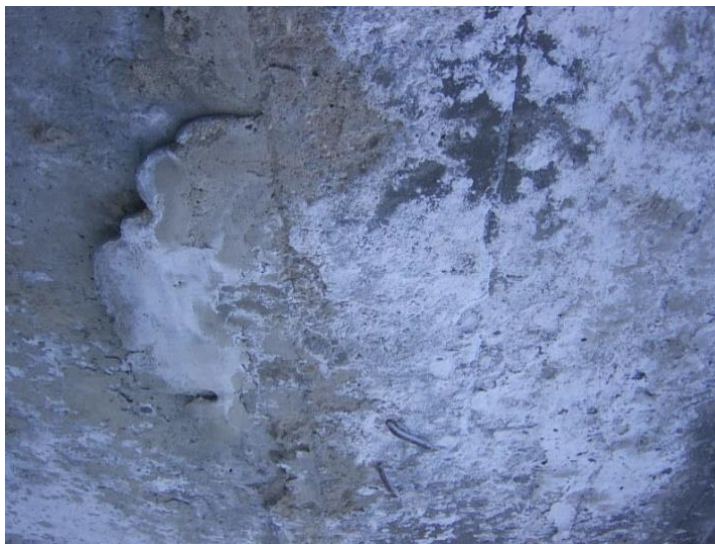
Рисунок 4 – Характерный внешний признак коррозии выщелачивания
