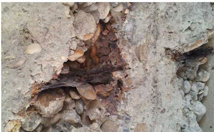
Рисунок 3 – Хлоридная коррозия бетона
