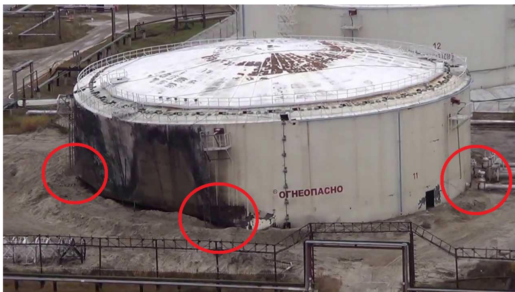
Рисунок 8 – Пример разрушения резервуара с нефтепродуктами и системы противопожарной защиты.
