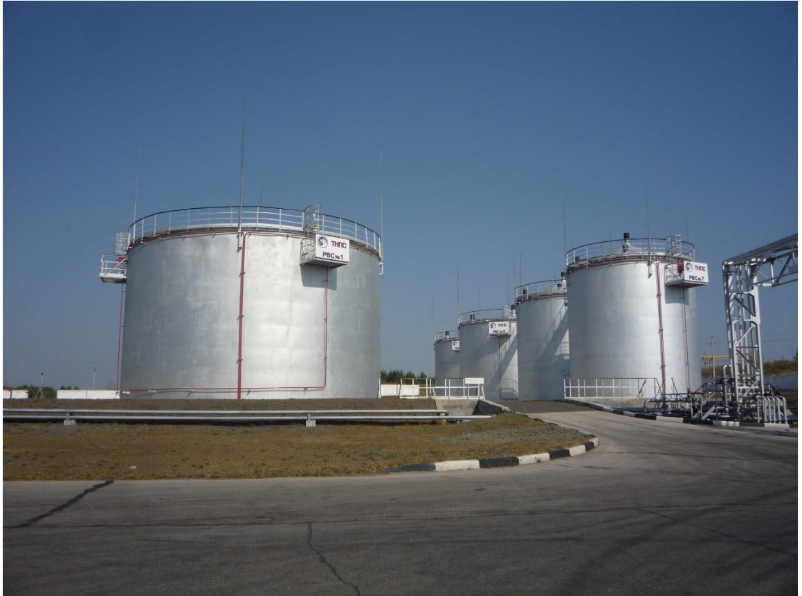
Рисунок 1 – Система резервуаров (резервуарный парк ЛВЖ, ГЖ)
