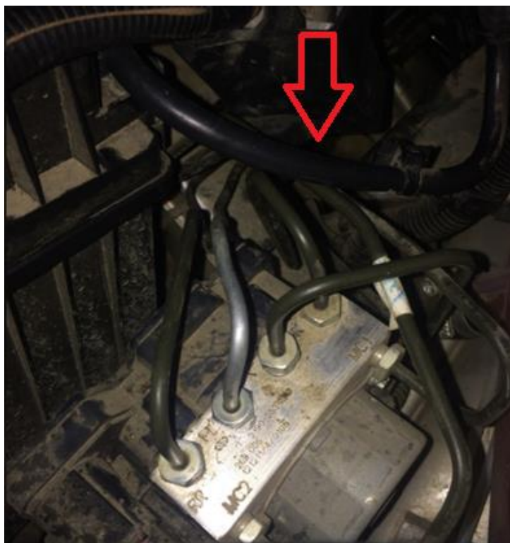
Рисунок 26 – Касание тормозных трубок с шлангом расширительного бачка
