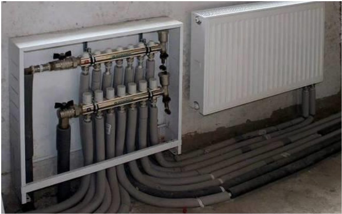
Рисунок 10 – Коллектор системы отопления
